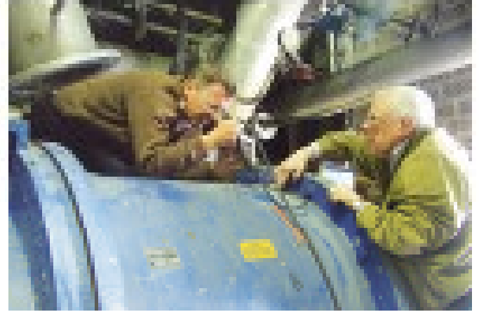
Richter servis teknisyenleri yerinde vakum kontrolü/kapasite testi yapıyor
